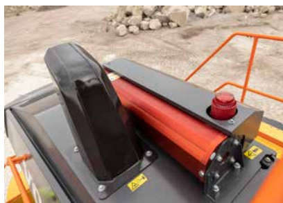
Sistema de extinción de incendios
